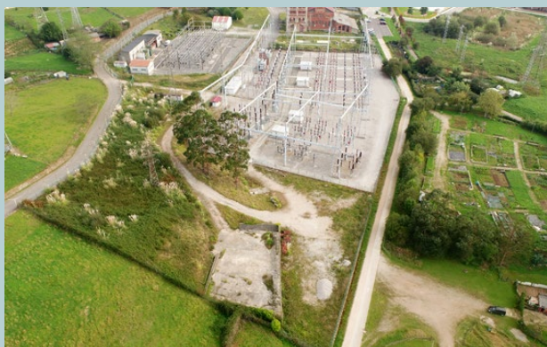
Foto aérea del aspecto de la Subestación.
