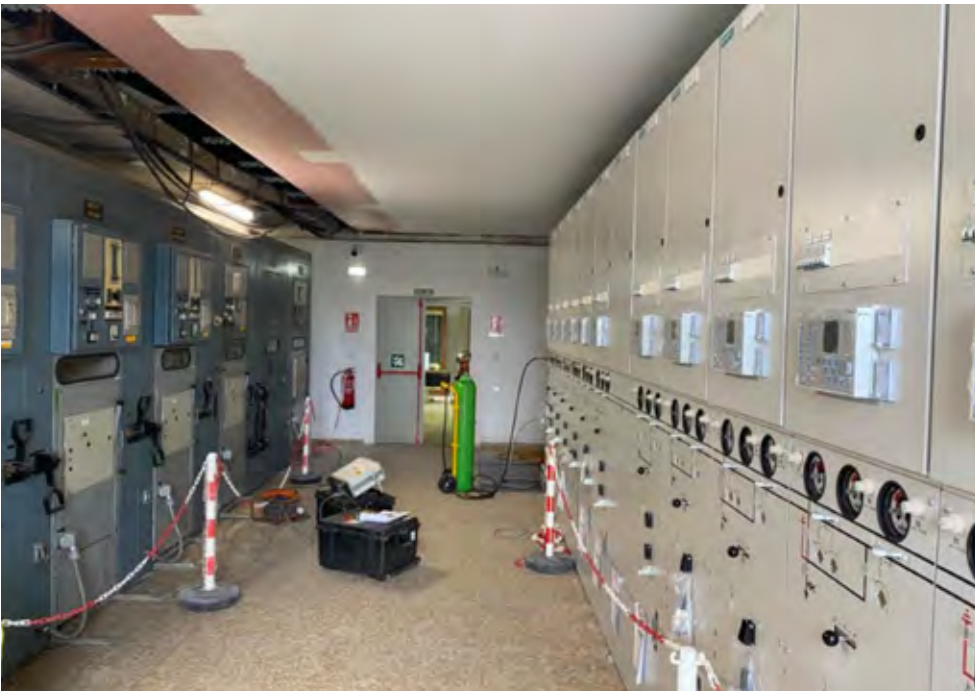
Nuevas celdas subestación Langreo
