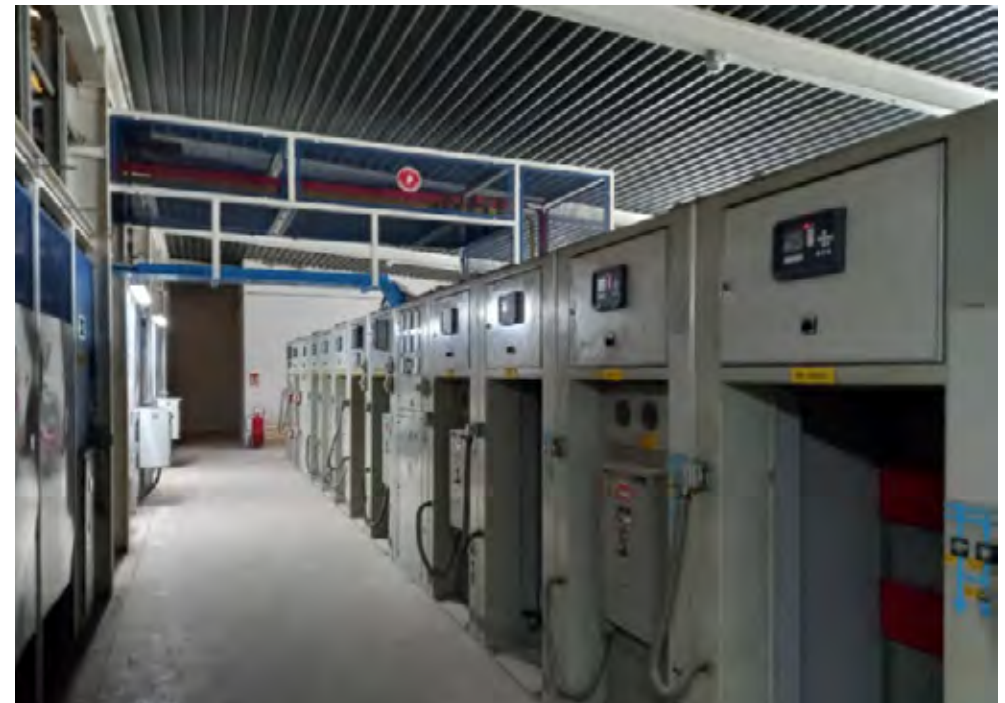
Subestación de Maliaño
