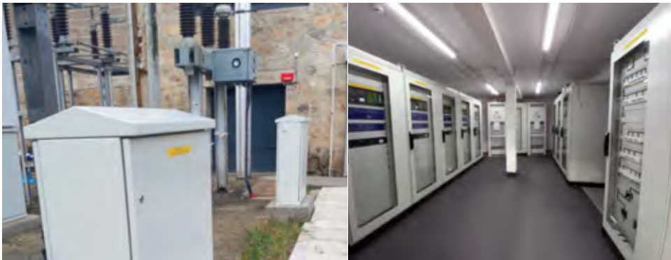
Subestación de Rozadio
